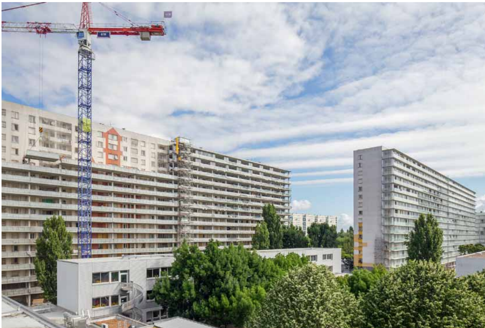
Montage der immer gleichen, auf der Südseite vorgefertigten Betonmodule. Rechts oben der Gebäuderiegel mit bereits fertiggestellter Ergänzung.
